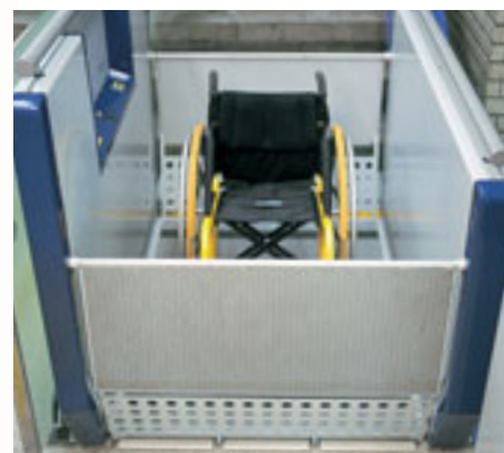
渡し板兼扉 人や車いすの落下防止のためのかご内車止め。
