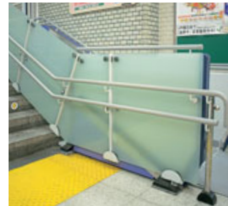
仕切り／手すり 歩行者が昇降機に手や物をはさむのを防ぐ仕切りと歩行に便利な手すり付き。
